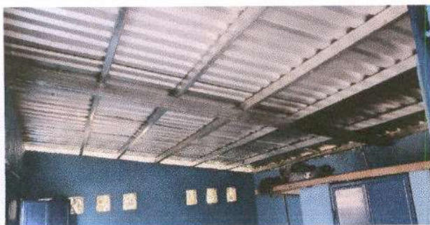
Foto 13: Cambio de laminas troquelada aluzinc calibre 26 total 15 metros. Y estructura de techo a razon que esta muy distante los durmientes o constaneras y eso permite que se unda el lienso de lamina
